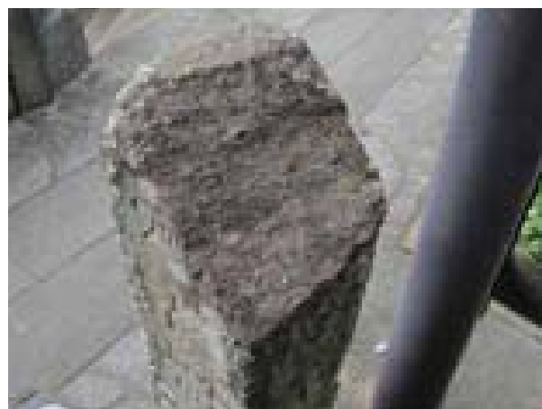
写真 50 第三十五號 頭部欠損状況
